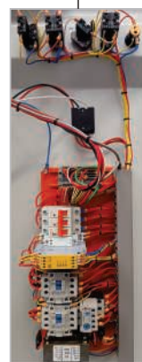
Elétrica adequada a NR-10 e NR-12
