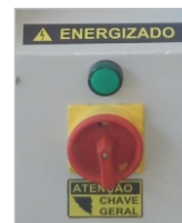
Chave geral e sinaleiro de equipamento energizado
