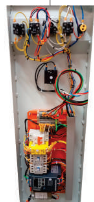
Elétrica adequada a NR-10 e NR-12
